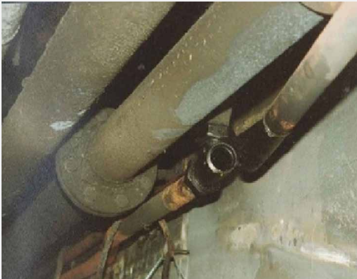
Dette bildet viser nærbilde av koblingen på returoljerøret fra hengedekket hvor koblingen var løsnet og røret kraftig bøyd, slik at store mengder brennbar væske ble pumpet inn i brannområdene. Det var forsvunnet ca. 120.000 liter med diesel på skipets tanker etter brannen, og mye av det mener vi at ble levert inn i denne korridoren som brant i nærmere 8 timer sammenhengende
